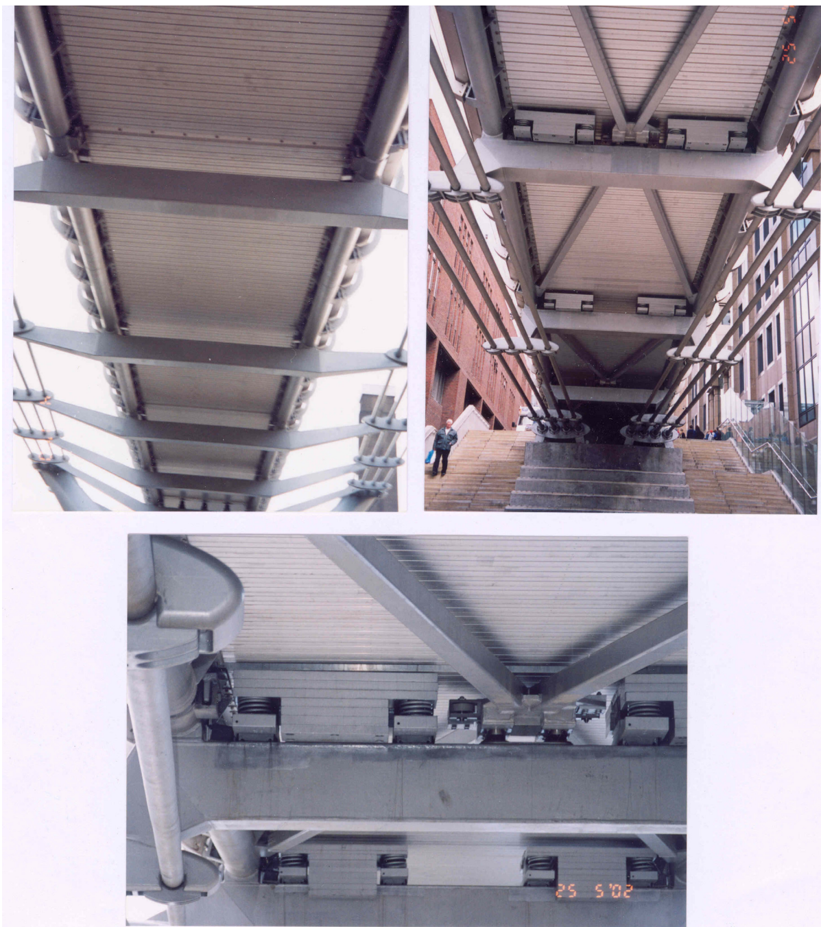
Obr. 3: Pěší most „tisíciletí“; původní stav bez příčného ztužení mostovky a stav po ztužení s hydraulickými tlumiči
